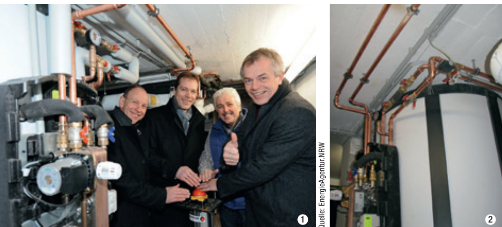
Abb. 2: (1) Feierliche Einweihung der ersten Anlage des Projektes 100 KWK, (2) installiert auf engstem Raum.
